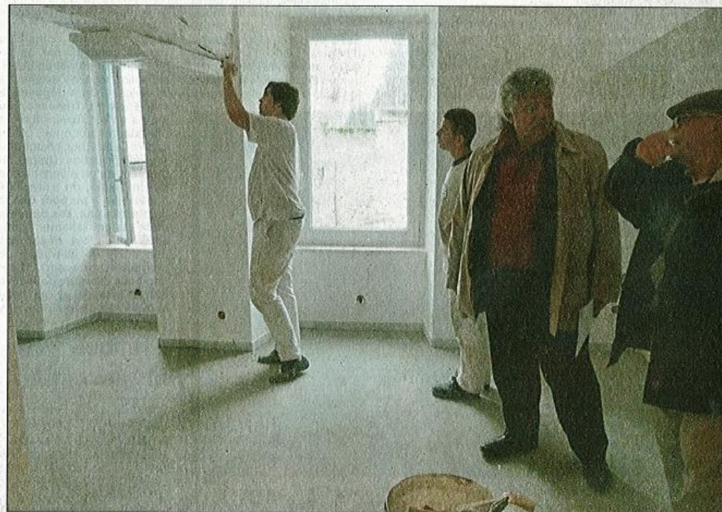
Les travaux de l'immeuble en rénovation place de la Révolution se termineront le 1 er décembre prochain.
